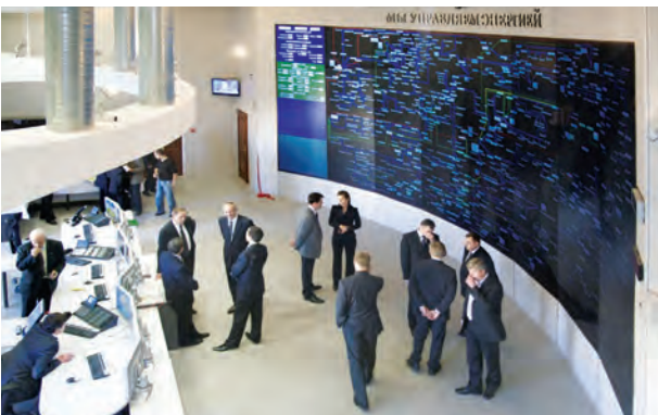
Центральный диспетчерский пункт (ЦДП) РДУ ОАО «Башкирэнерго»
